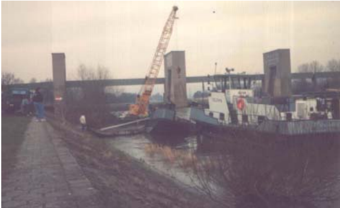
1989 Auspumpen eines leckgeschlagenen und Teilgesunkenen Arbeitsschiffes
