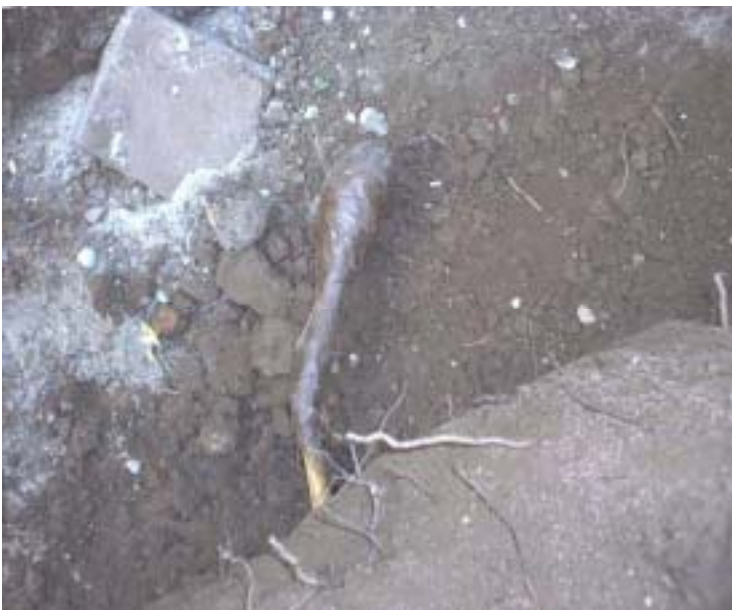
Gaseinsatz nach Abreißen einer Gasleitung durch einen Bagger
